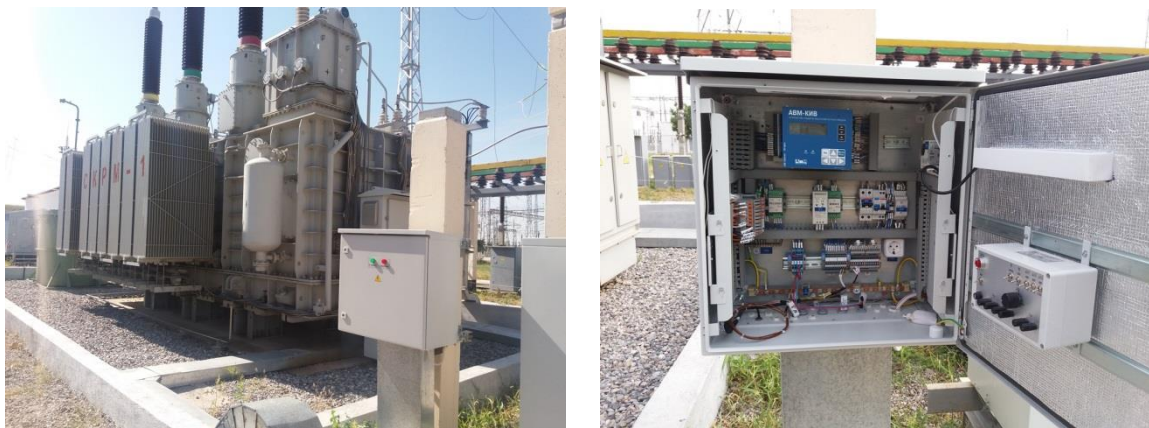
Рис.3 Устройство АВМ-КИВ на ПС «Шымкент» (Казахстан)
